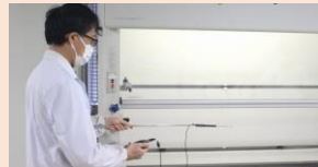
局所排気装置定期自主検査
